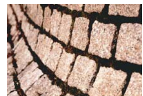
図14 傾斜した擁壁にはコケが生える
